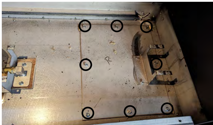
Figure 18.15.02: Plaque d'accès au ventilateur côté droit
