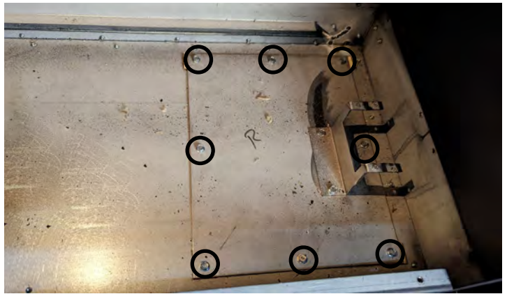
Figure 18.15.02: Plaque d'accès au ventilateur côté droit
