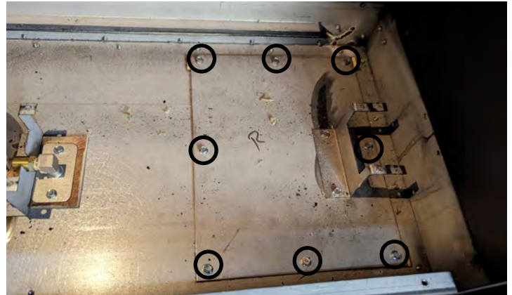
Figure 18.15.02: Plaque d'accès au ventilateur côté droit
