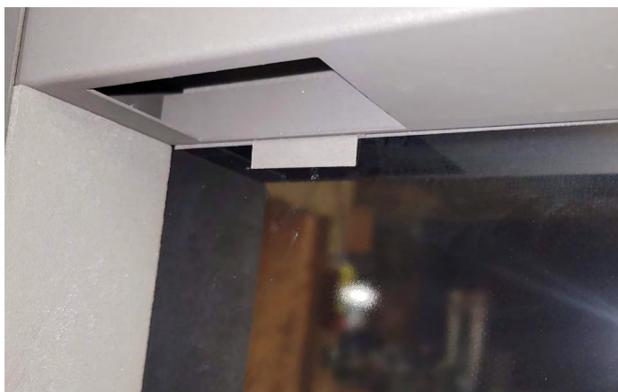
Figure 17.2.03: Clip de retenue de verre installé
